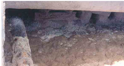
Figura 4.1 Fuga de gasolina en la fractura de una tubería por cambios volumétricos en el suelo al variar el contenido de agua (expansión–contracción).
