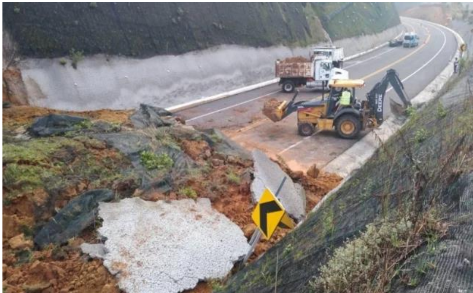
Figura 1.1 Derrumbe en la autopista Toluca-Zitácuaro en el km 50+800
