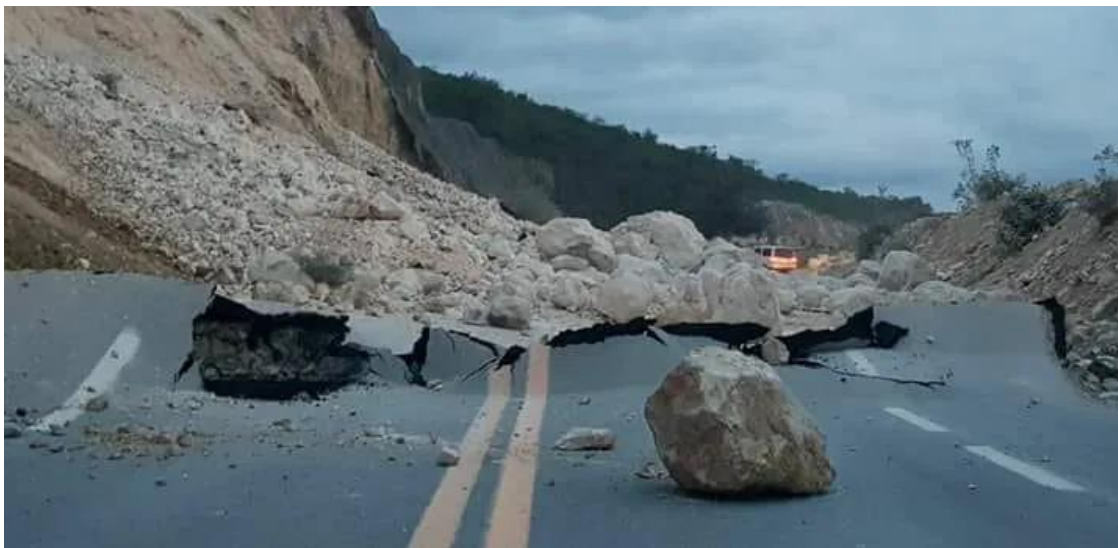
Figura 1.2 Derrumbe en la autopista Cuacnopalan-Oaxaca en el km 102+800
