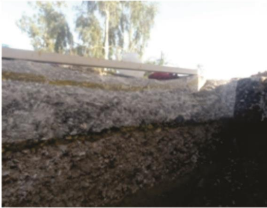
(a) Falla de la carpeta asfáltica, rodada izquierda
