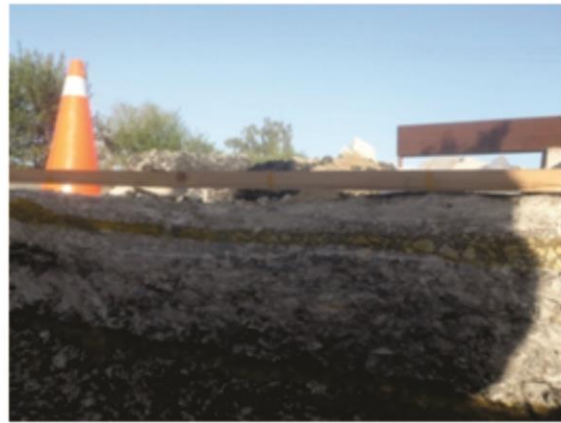
(b) Falla de la carpeta asfáltica, rodada derecha
