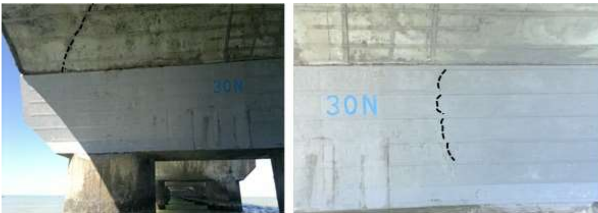
Figura 2.5 Nuevas fisuras observadas sobre el apoyo 30 del viaducto
