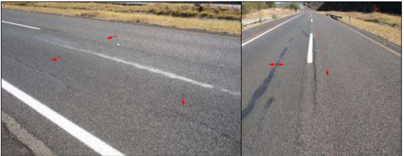
Imagen 5.11 Superficie del pavimento del terraplén T1A22
