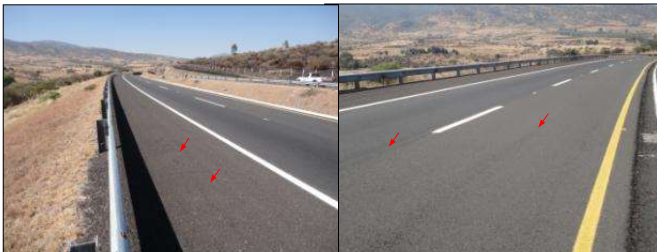
Imagen 5.2 Superficie del pavimento del Terraplén T1A02
