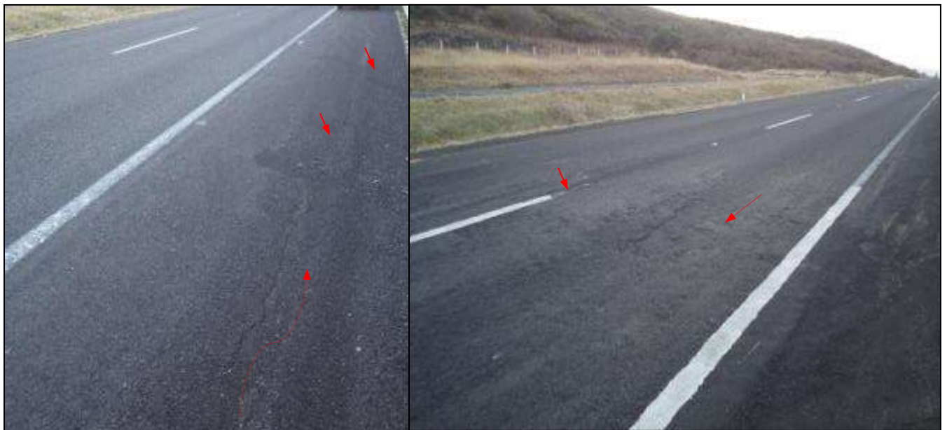
Imagen 5.9 Superficie del pavimento del terraplén T1A18
