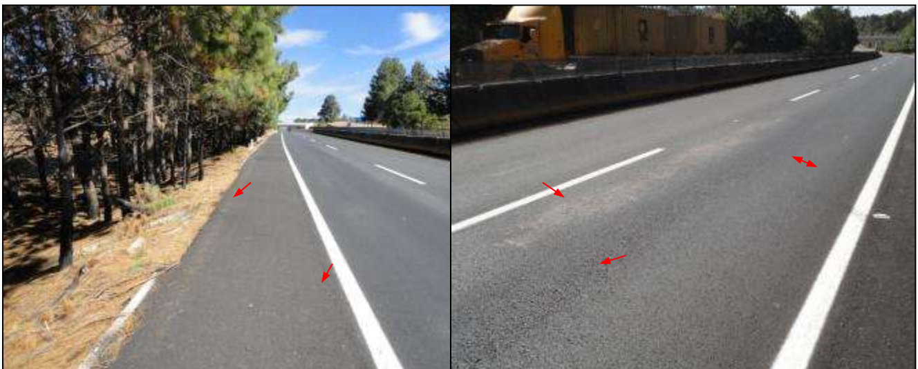
Imagen 5.4 Superficie del pavimento del terraplén T1A09.
