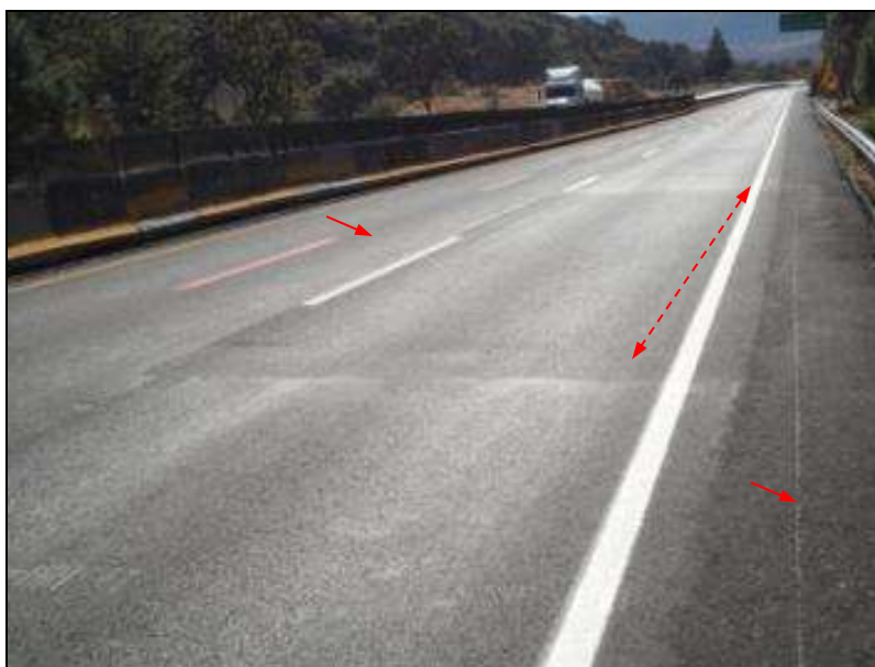
Imagen 5.7 Superficie del pavimento del terraplén T1A12
