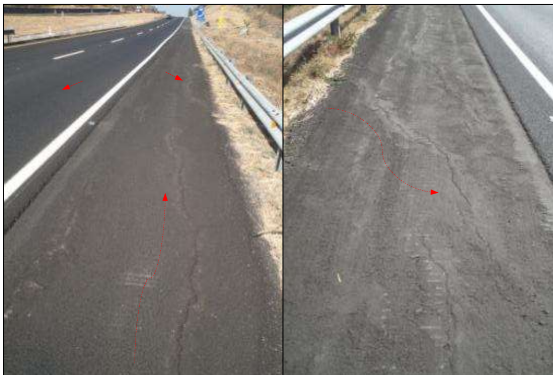
Imagen 5.16 Superficie del pavimento del terraplén T3A39
