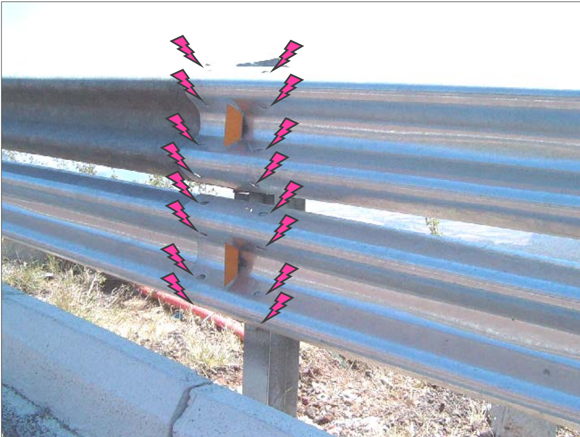
Fotografía 3.9 Barrera sin tornillos de unión entre sus elementos
