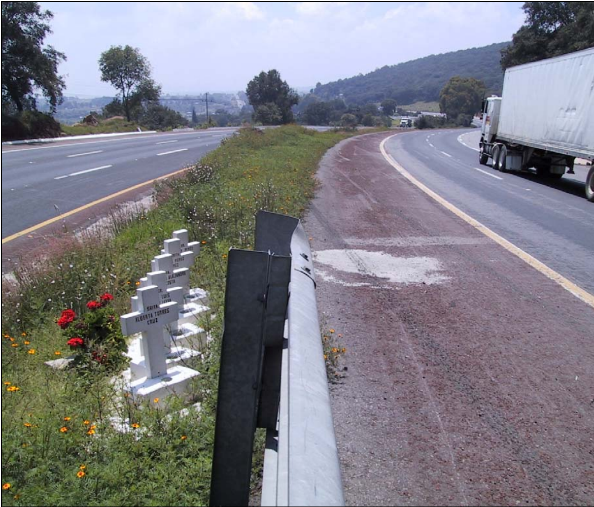
Fotografía 3.4 Falta de continuidad de una barrera metálica en una curva
