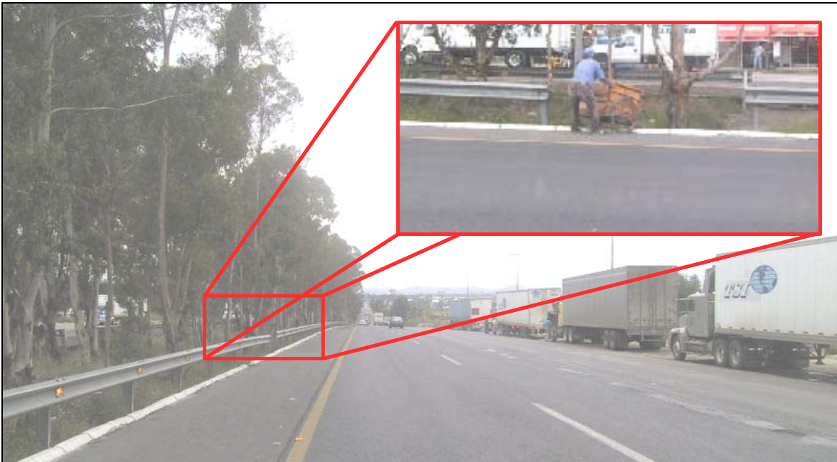
Fotografía 3.1 Discontinuidad en una barrera metálica lateral
