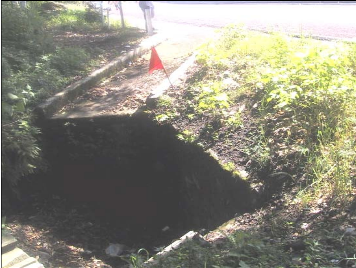
Fotografía 3.8 Alcantarilla sin protección
