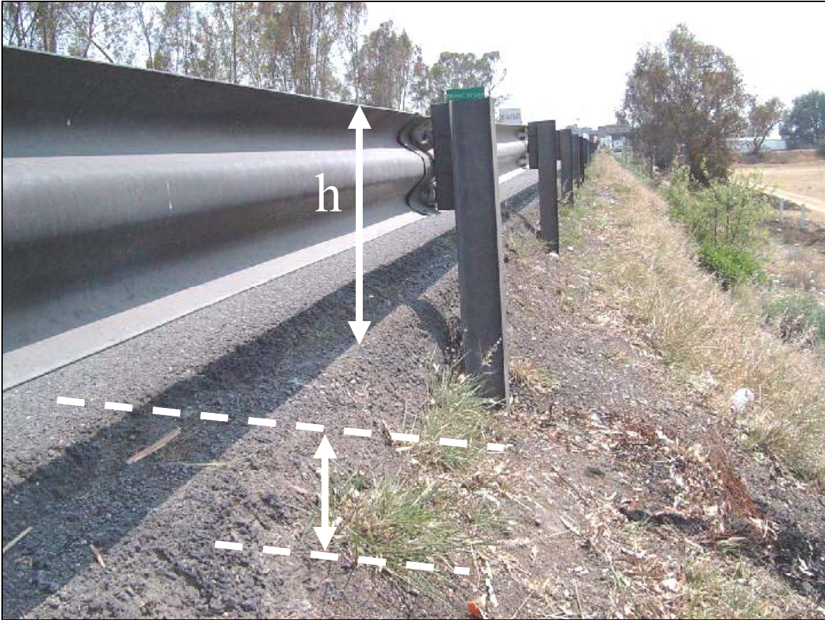
Fotografía 3.11 Altura inadecuada de la barrera
