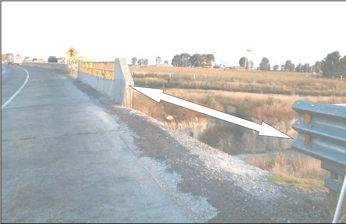
Fotografía 3.10 Falta de un elemento de transición entre la barrera metálica y el puente
